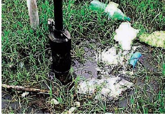
A: mala perforación de pozos
